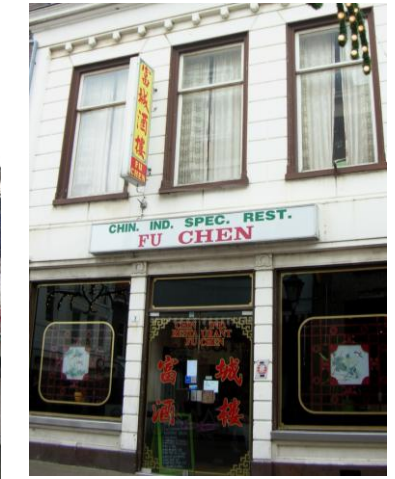
Korte Dam 3-5 Foute reclame. 2 lichtbakken, waarvan 1 te hoog zit (tussen ramen verdieping) en de ander te breed en te hoog is
